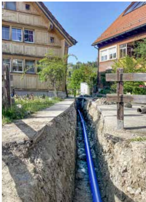
↑ Versorgungsleitung Feld - Schwendi
